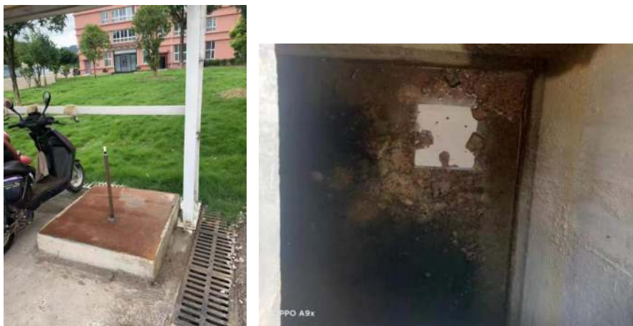
图 5-2 重点监测单元 A——初期雨水池
