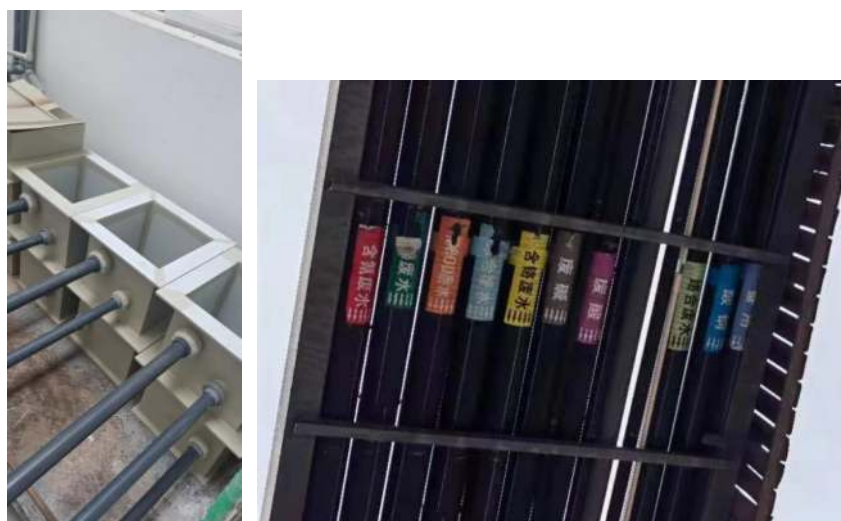
图 5-1 重点监测单元 A——电镀线（车间内）收集池（左）、电镀线生产区域架空管线（右）
