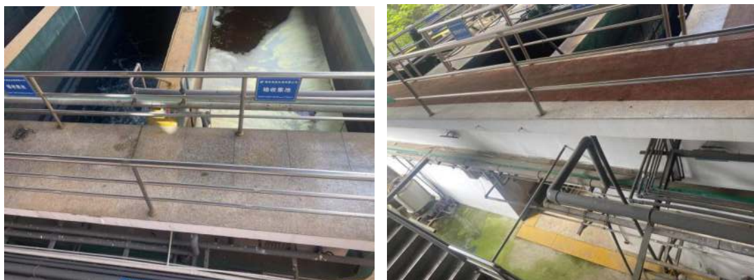
图 5-3 重点监测单元 B——污水处理区收集池（左）、调节池（右）
