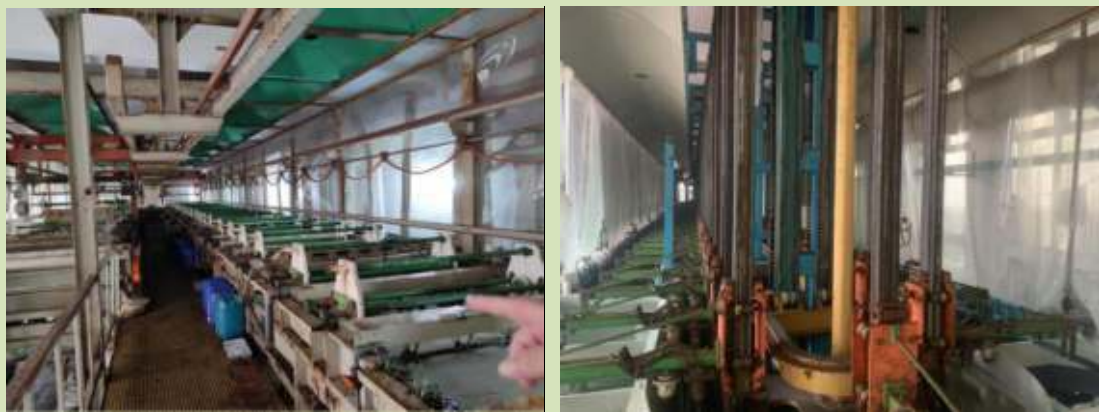
图3-38 现有废气收集情况
